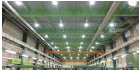
LED照明灯(菊川工場)
