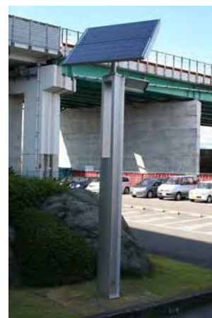
ソーラー・LED照明灯
